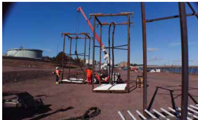
Das TEX-FLEX®-Belüftungssystem auf der Produktionsanlage von ExxonMobil, Norwegen
