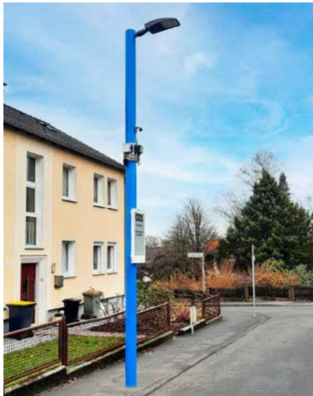
Modularer Beleuchtungsmast im Quartier Schöller-Dornap ENGIE Deutschland
