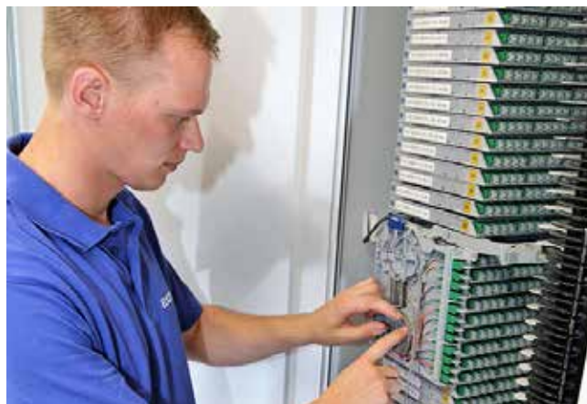
Vom POP (Point of Presence) eines Netzbetreibers erfolgt die Datenübertragung via Hochleistungs-Glasfaserleitungen
