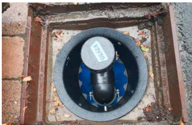
Jetzt gehts den Ratten an den Kragen: Rechtssicherer Einsatz mit integrierter Köderstation für den Regenwasserzulauf am Straßenrand
