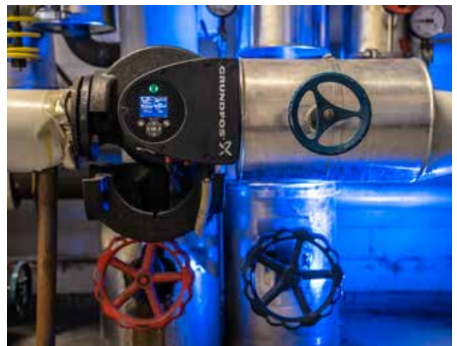
Betreiber, die ihren Pumpenbestand modernisieren, profitieren auf mehreren Ebenen Quelle: pesContracting/Mario Dirks
