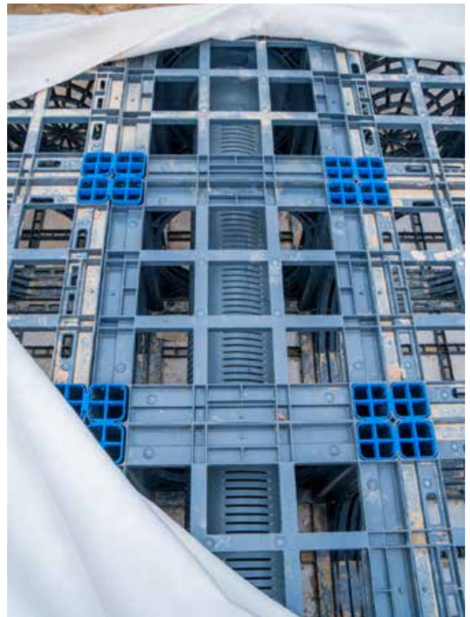
Die D-Raintank 3000®-Elemente wurden im Bereich der Anschlüsse zusätzlich mit Spülrohren ausgestattet. Diese sind so konzipiert, dass sich mitgeführte Feststoffe aus dem Niederschlagswasser an der Rohrsohle sammeln. Mittels regelmäßig durchgeführter Spülungen können diese Feststoffe beseitigt werden. Foto: Funke Kunststoffe
