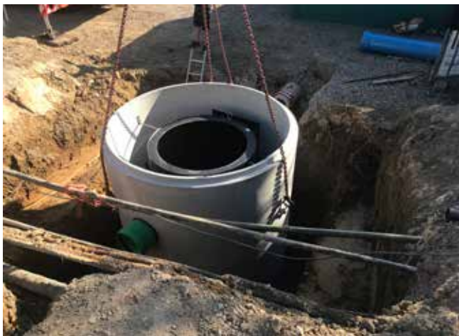
Die Anlage befindet sich in einem DN 2500er Betonschacht. Sie behandelt das Niederschlagswasser physikalisch und entfernt abfiltrierbare Stoffe weitgehend aus dem Regenabfluss.
