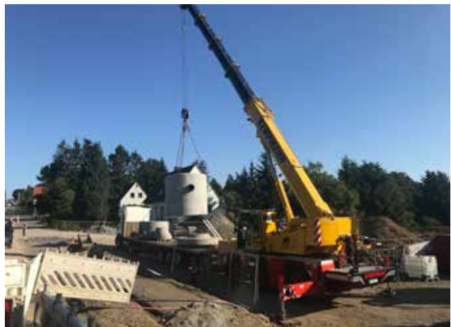
Die Straßenentwässerung auf der L561 zwischen Schalksmühle-Heedfeld und Lüdenscheid erfolgt über das System „Hydroshark“ der Finger-Beton Unternehmensgruppe.
